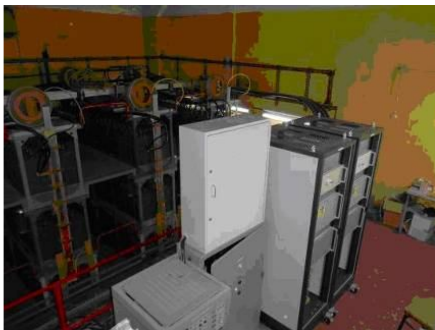
Рисунок 1 - Фотография зарядных устройств, установленных в конденсаторном отсеке.
