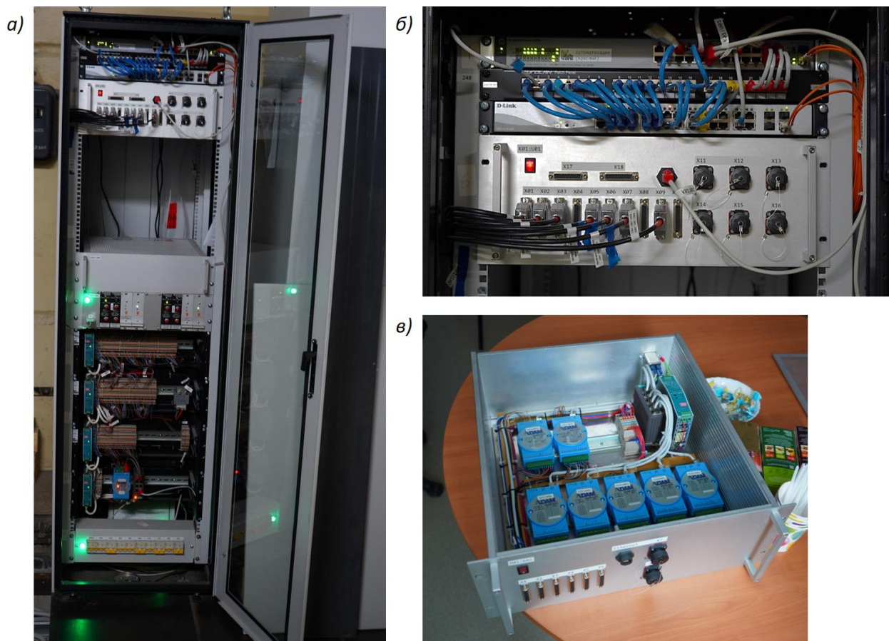
Рисунок 45. Монтаж измерительных устройств: а) общий вид стойки; б) маршрутизаторы и скомпонованные блоки ввода-вывода; в) внутреннее наполнение 19 дюймового корпуса.
