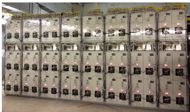
Рис. 3. Система импульсного питания в сборе: 48 модуляторов установлены в 8 стоек.
